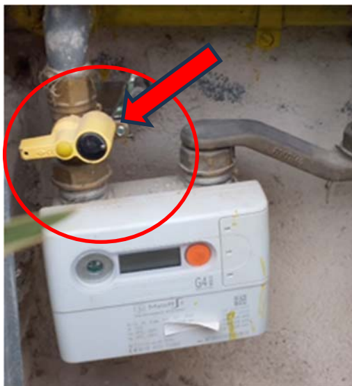
Valvola a monte del misuratore
